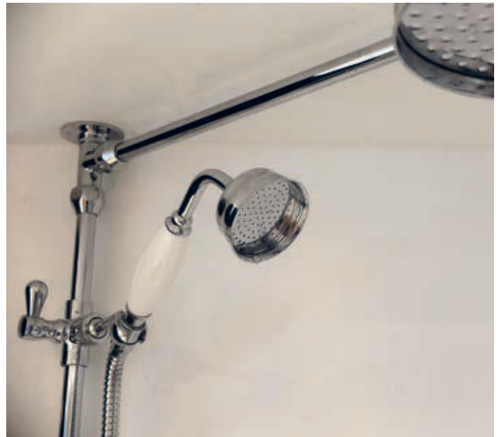
Abbildung 3: Die meisten Probleme mit Legionellen ergeben sich peripher in den Duschen bei Armaturen, Brausen oder Schläuchen, also auf den letzten Metern der Verteilung.
